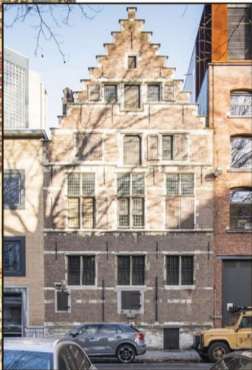
Het Brouwershuis, hier aan de zijde van de Brouwersvliet, wacht nog op restauratie. Foto: Frederik Beyens
